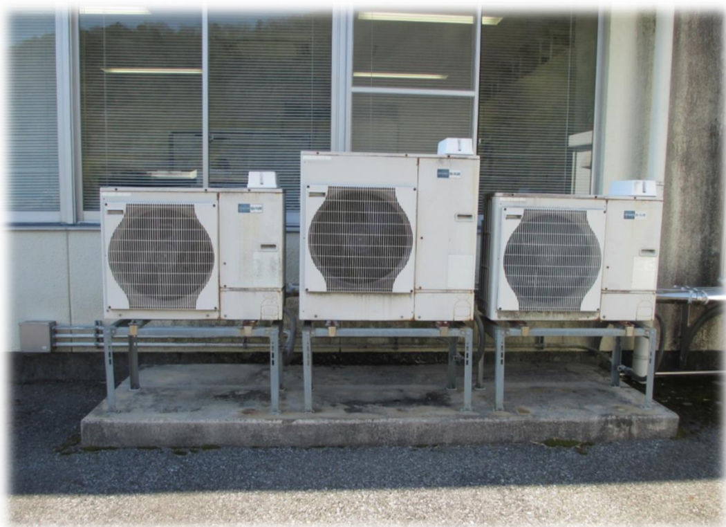
既設空調室外機AC-3の設置状況
